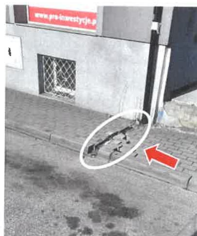
ul. Styki 1, uszkodzony chodnik przy odpływie z rynny
