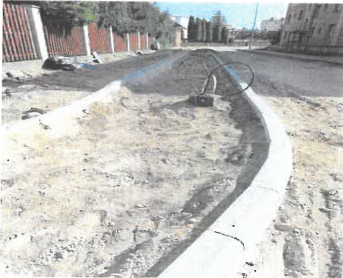
Lampy na projektowanej ścieżce rowerowej
