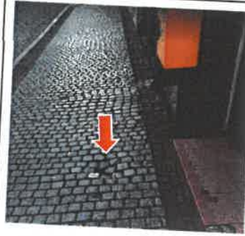
zapadnięcie chodnika ul. Reja 21
