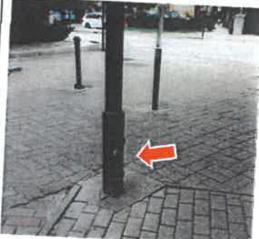
Brak pokrywy, wystające przewody latarni - ul. AK (Pekao SA)
