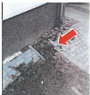
Brak zabruku przy budynku nr 19, ul. Przyzamecze
