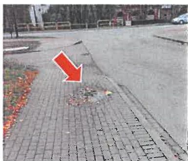
Zapadnięcie chodnika ul. Marcinkowskiego/ Al. Niepodl.
