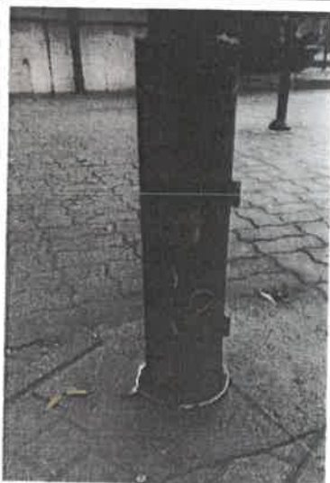
Nie świeci latarnia przy Banku PKO SA, niezabezpieczona komora przyłącza
