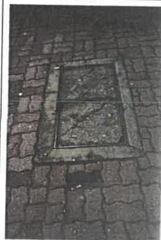
Ubytek w chodniku ul.; Targowa od strony A1. Niepodległości (na wysokości nr 59)
