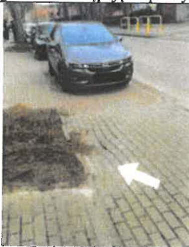
zapadnięcie chodnika, ul. Marcinkowskiego, wejście do ZSMI
