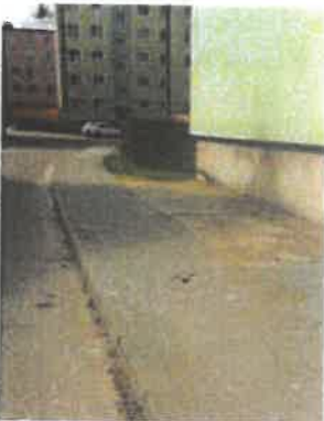
ul. Jagiellońska 6, zapadnięcie chodnika ( Ponownie )
