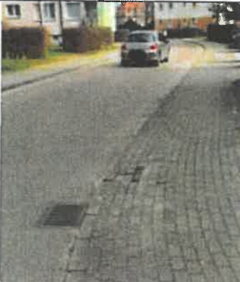
ul. Jagiellońska 7, zapadnięcie chodnika ( Ponownie )
