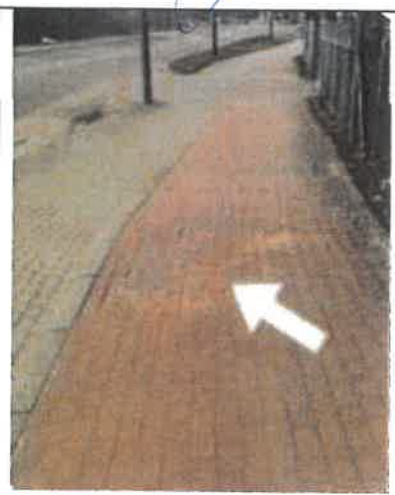
ul. Słupska 17, zapadnięcie nawierzchni drogi dla rowerów
