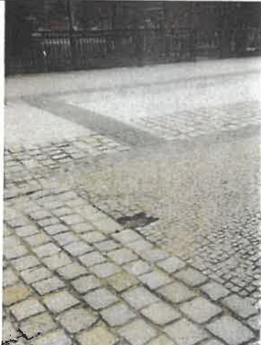
ubytek w zabruku, most w ciągu ul. Staromiejskiej,
